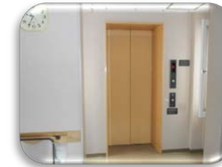
▲エレベーター
